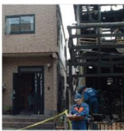
隣家火災 写真左:レスコハウス
